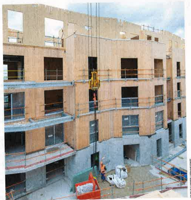
Le programme Abélia, réalisé par Woodeum à Bry-sur-Marne, en structure mixte acier-bois, sera livré en avril 2021.
